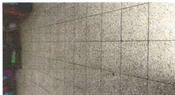
Foto 4: Sustrucción de piso de granito
