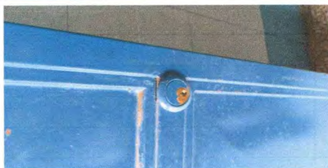
Foto 2: Sustrucción de chapa.
